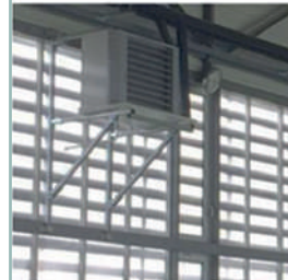
Aérotherme du gymnase
